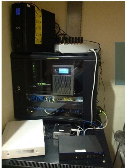
Foto 3. Cabina-Rack, equipos de telecomunicaciones parte superior en NAMIRA S.A.
