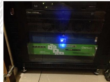
Foto 5. Equipo Central Telefónica DENWA en NAMIRA S.A.
